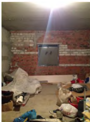
Рисунок 36. Опасное хранение стройматериалов и старых вещей.
